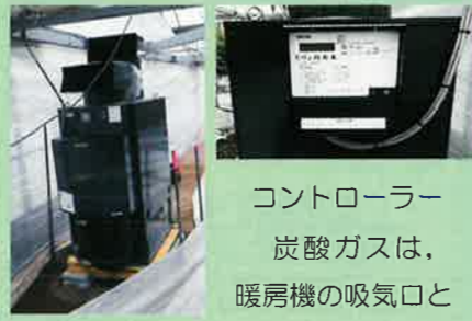
コントローラー 炭酸ガスは、暖房機の吸気口とダクトを通じてハウス全体に供給
