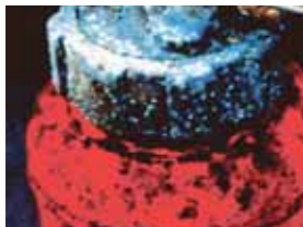
消火器上部の腐食
