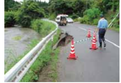
▲平成20年9月の台風15号による伊集院町上神殿での路肩決壊
