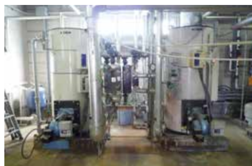
ゆーぷる吹上の機械室
