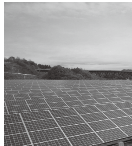
太陽光発電設置箇所
