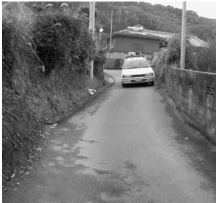
危ない！補修のメドも立たず放置された生活道路
