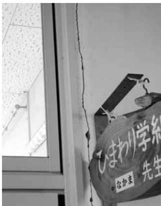
伊集院小校舎内のひび割れ
