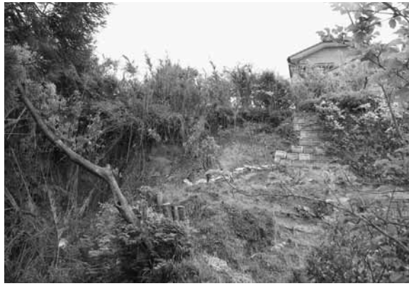
朝日ヶ丘団地北側の法面崩壊
