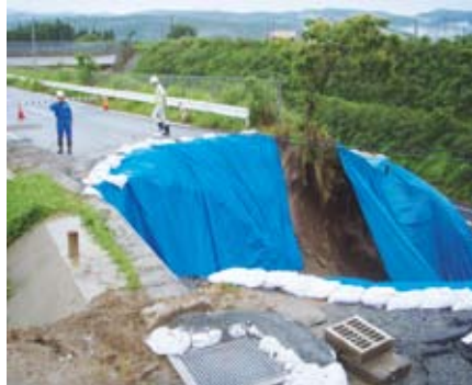
▲平成22年6月21日 南九州道のり面崩落に伴う市道陥没
