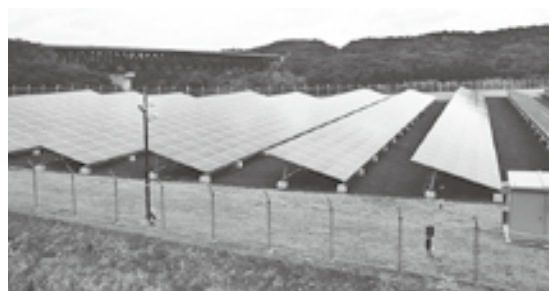
市内に設置された太陽光発電
