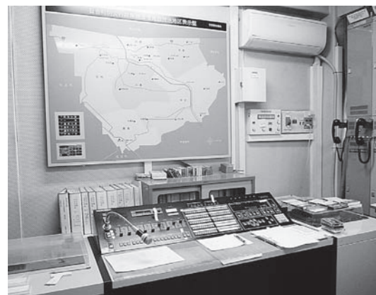
老朽化した日吉支所防災無線
